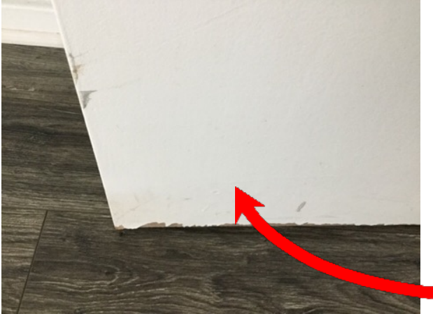
Door - Peeling paint
