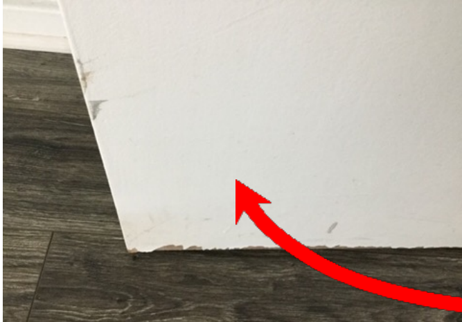
Bedroom 1 Door Peeling paint
